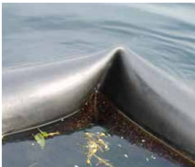
Figur 7 Lokal knekking av plastrør.
